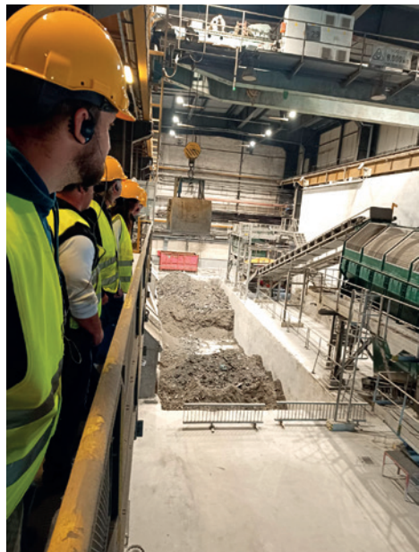
Prostor pro shromažďování popela vzniklého při spalování komunálního odpadu v areálu SAKO Brno a. s.
