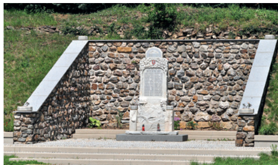
Pomník padlých v 1. světové válce po opravě.
